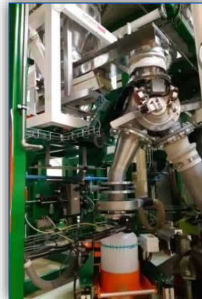
Poste de chargement du mélangeur de la ligne centre.
