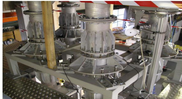
Le risque de criticité est maîtrisé par le diamètre de l'équipement industriel
