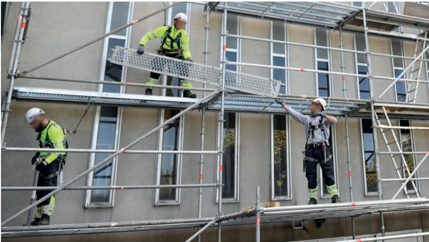
D'importants travaux de rénovation thermique sont en cours sur le bâtiment du Conseil départemental de la Drôme (Valence)
