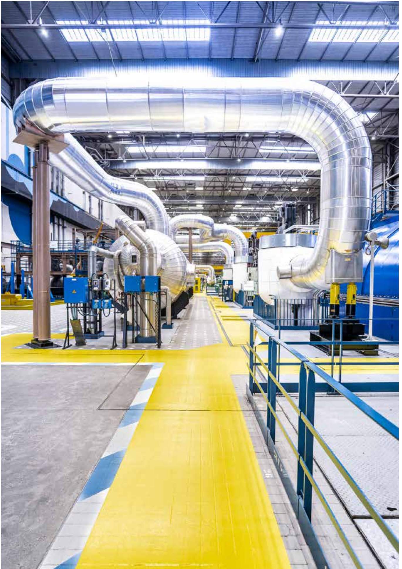
La salle des machines de la centrale du Tricastin
