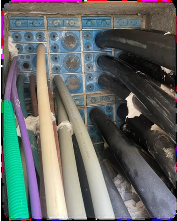
Passage de câbles dans cadre ROXTEC
