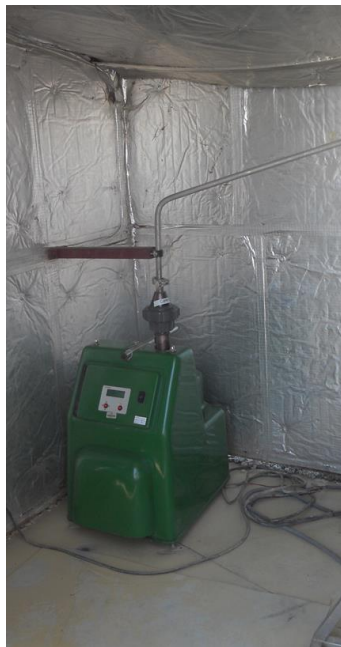
Equipement de prélèvement en cheminée
