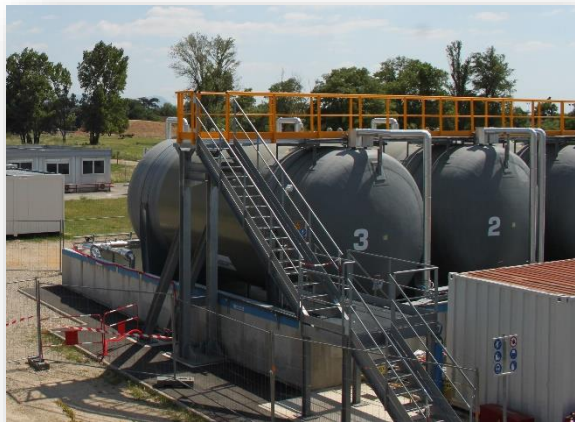
Prévention des déversements par la mise en œuvre de rétentions
