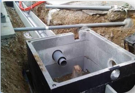
Mise en double enveloppe des réseaux véhiculant des effluents chimiques et/ou uranifères
